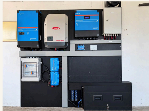
Sistema solar e baterias
